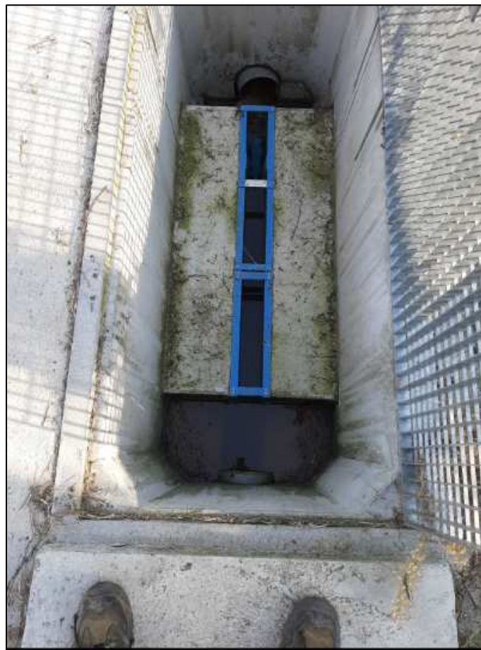
Figure 1 : vue du canal venturi implanté en entrée de station d'épuration.
